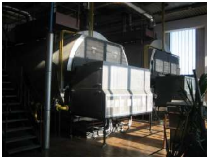
Fotografija 6: Notranjost kotlarne v Novi vasi
