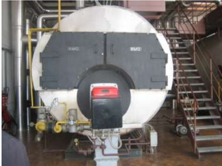
Fotografija 5: Plinska peč v kotlarni Nova vas
