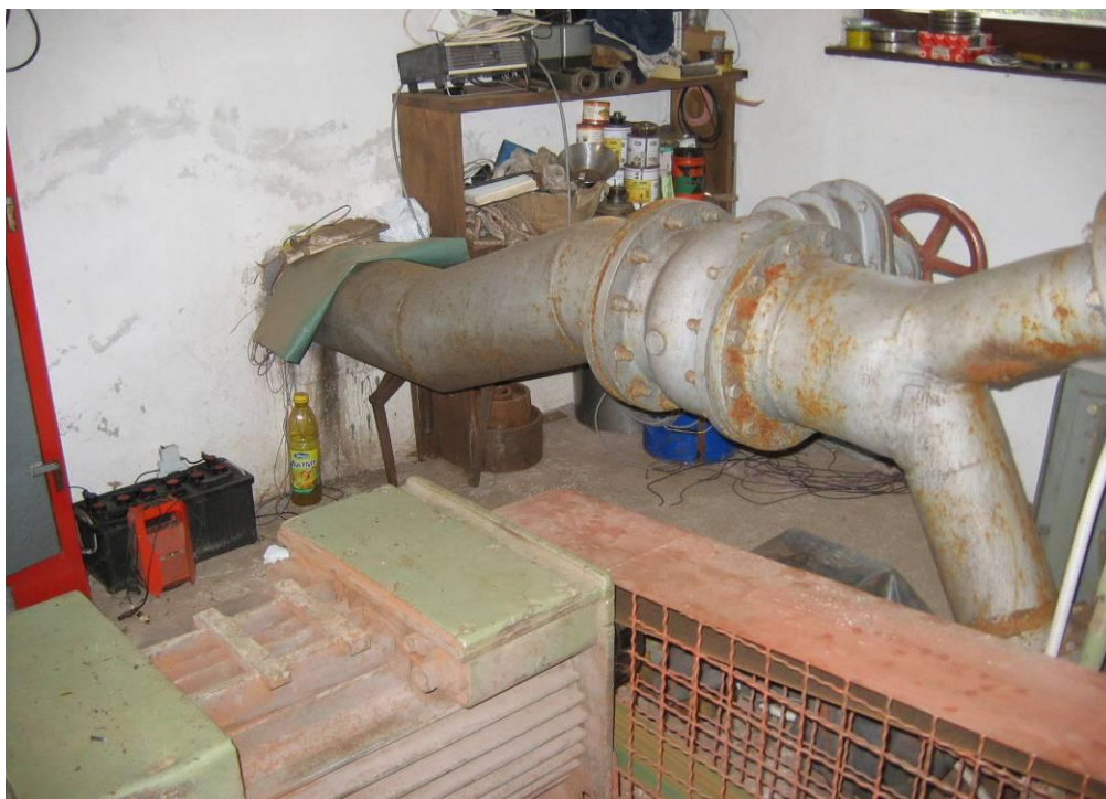
Slika 7: Dovodna cev s strojnico mHE
