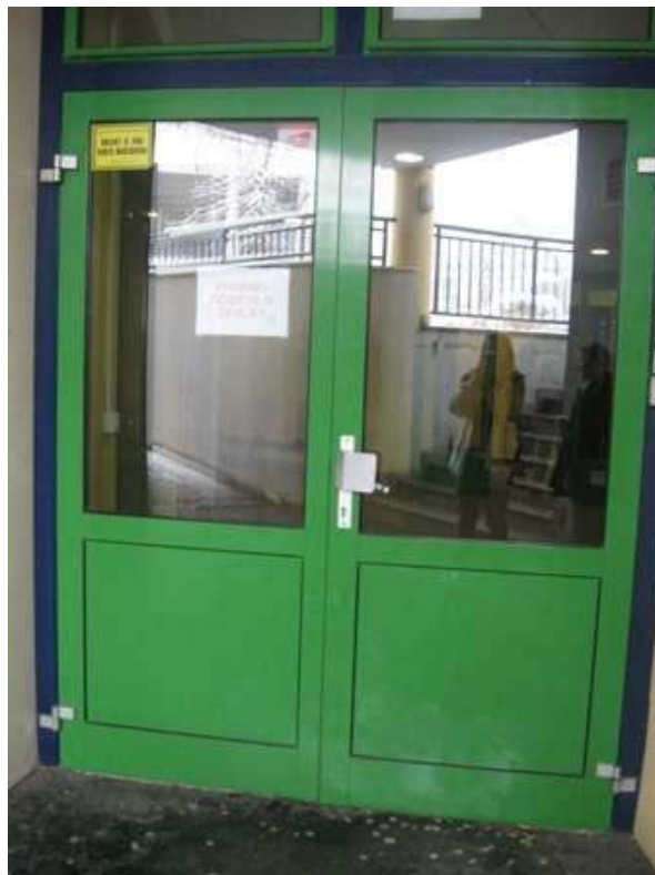
Slika 455: Vhodna vrata vhoda, ki je prilagojen dijakom na invalidskem vozičku
