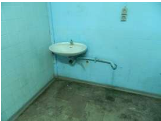
Slika 35: Nakazana umivalnica v moškem predprostoru brez odtoka in vode
