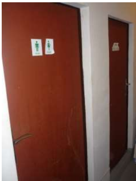
Slika 32: Sanitarije v zaklonišču
