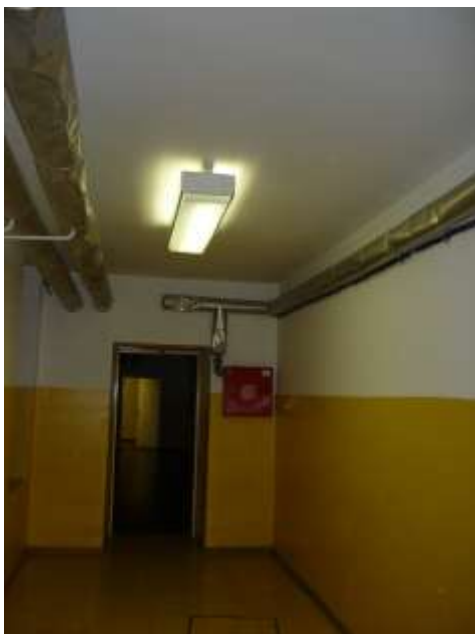
Slika 10: Cevi za dovod zraka
