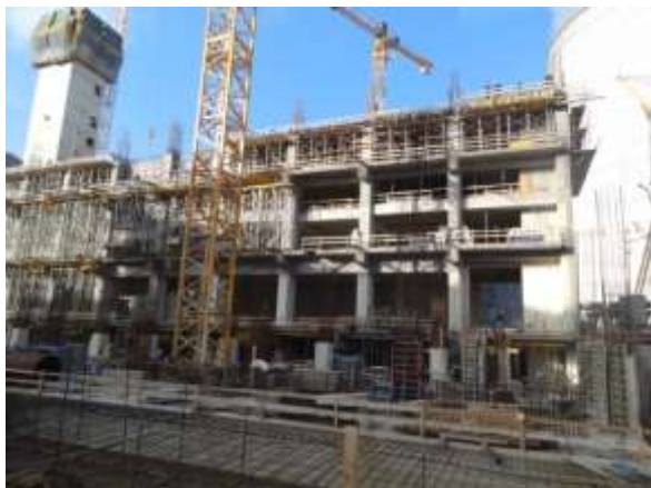
Slika 48: bunker in strojnica plošče
