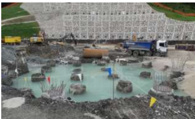
Slika 22: vidno dvignjena podtalnica med piloti
