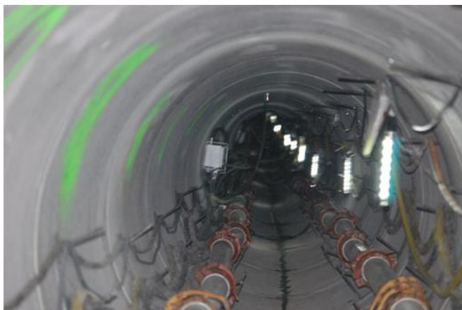
Slika 29: Prikaz znotraj cevi (feed line, slurry line, inštalacije)
