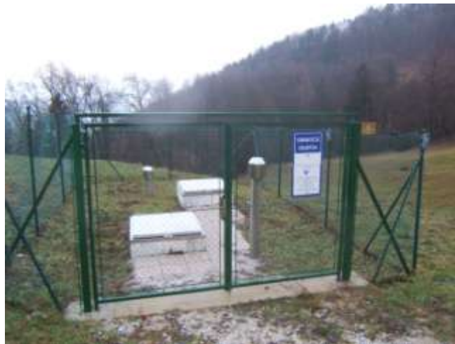
Slika 3: Prečrpališče z vrtanim vodnjakom
