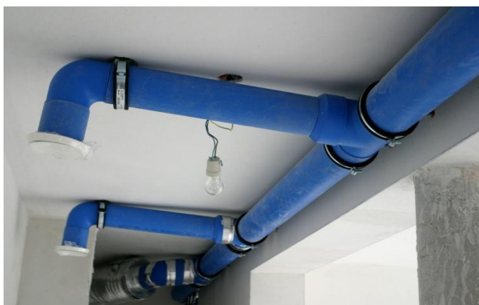
Slika 49: cevi pod stropom
