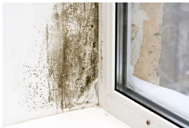
Slika 8: posledica vlage pri oknu
