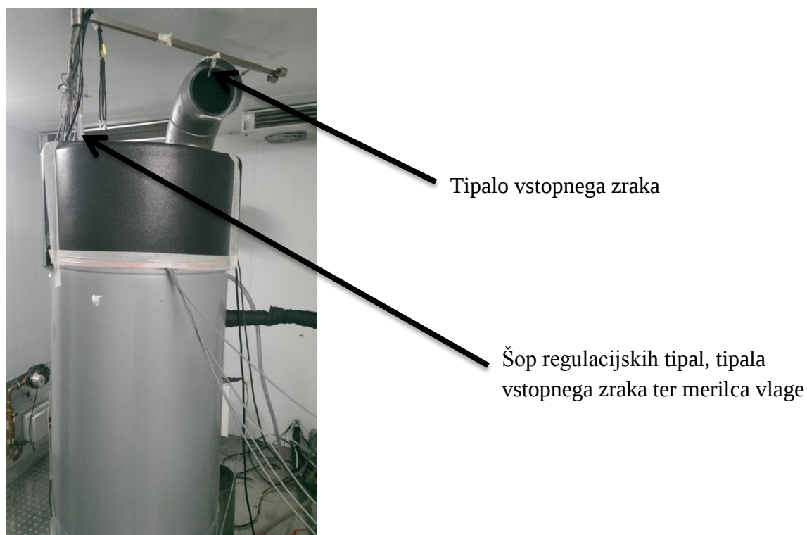
Slika 5: Priklop toplotne črpalke
