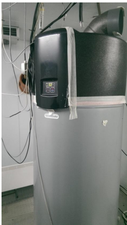
Slika 3: Toplotna črpalka v komori
