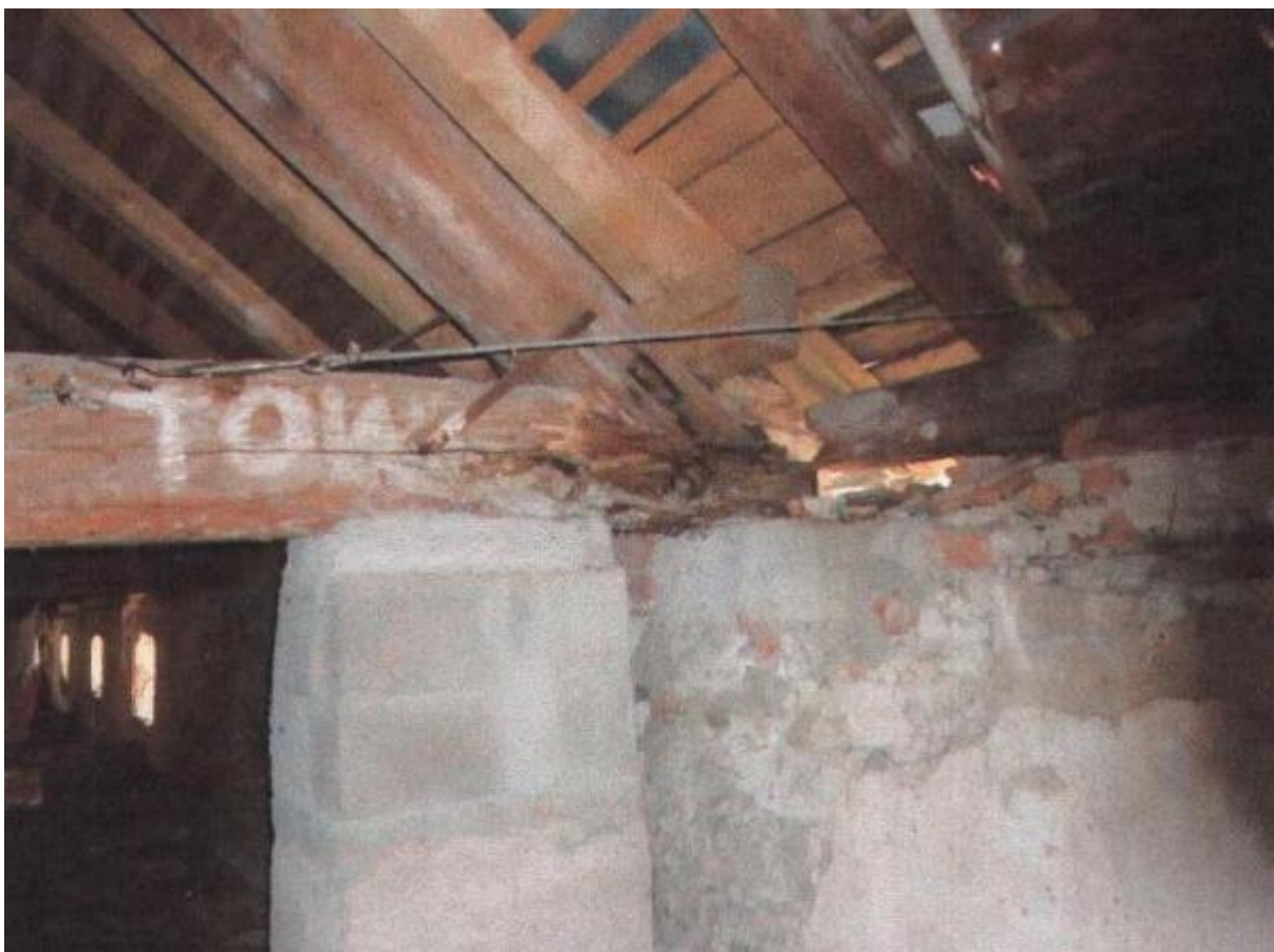
Slika 21: Poškodovano ležišče strešnega povezja je bila posledica zamakanja strehe. Foto: Tomaž Klančnik.
