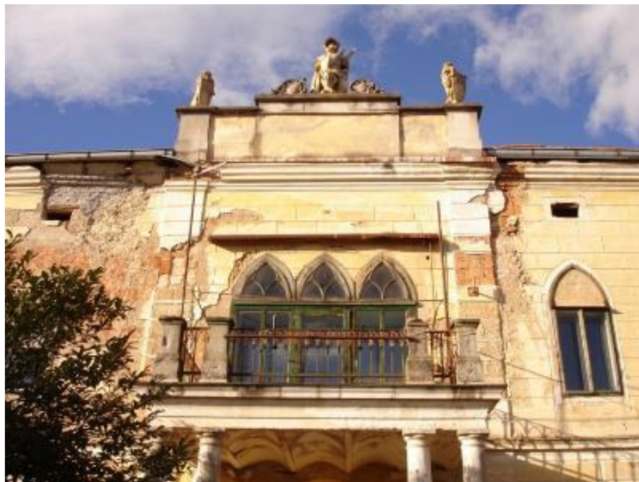
Slika 48: Zob časa je načel pročelje stavbe. Atika nad balkonom glavnega vhoda je še v dobrem stanju. Foto Bojan Rebernak.
