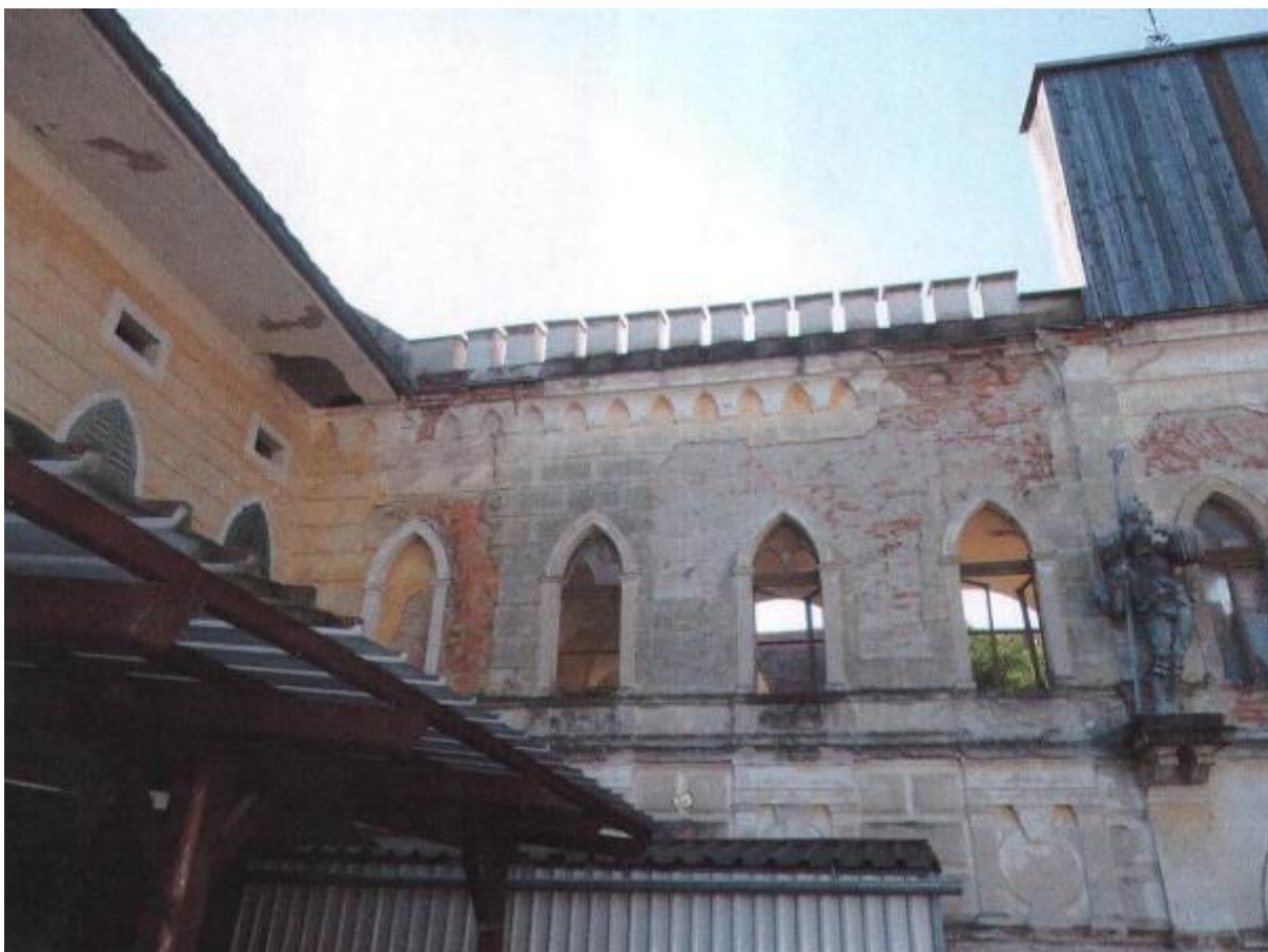
Slika 23: Z razpokami poškodovan zgornji del fasadnih zidov nad vhodom na dvorišče bivalnega dela. Foto: Tomaž Klančnik. Vir: Klančnik, Tomaž, September, 2012.
