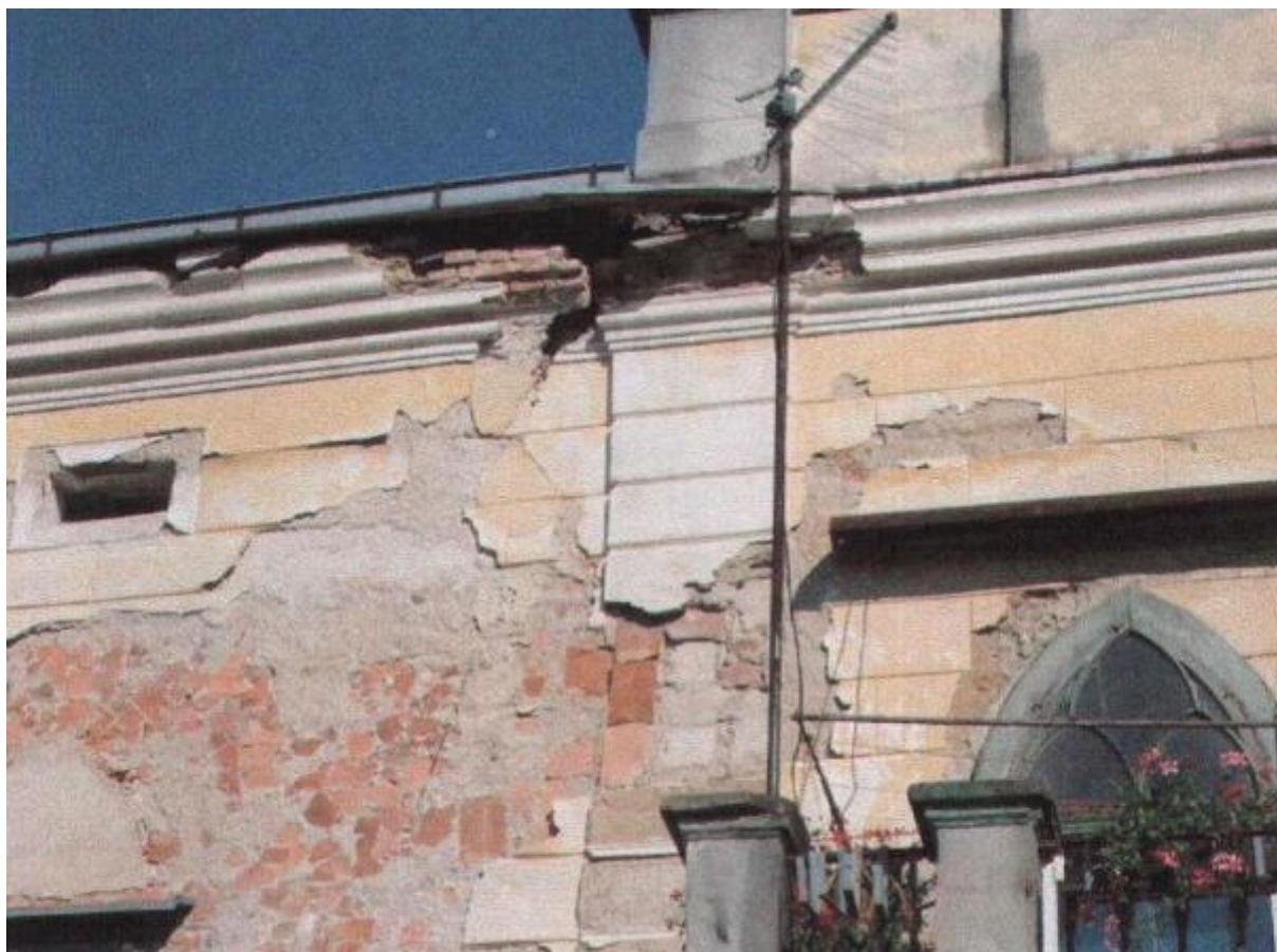
Slika 20: Poškodovan napuščni izzidani venec na vrhu jugovzhodne fasade. Foto: Tomaž Klančnik. Vir: Klančnik, Tomaž. September, 2012.
