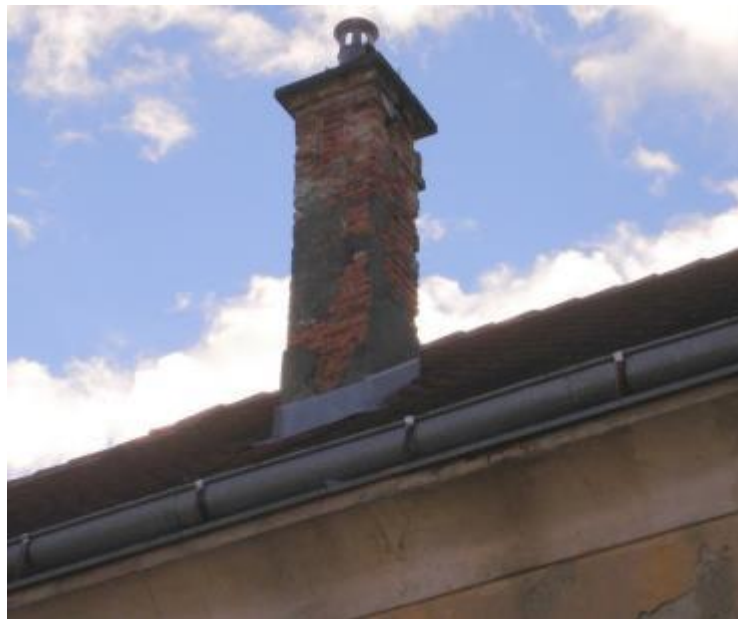
Slika 46: Slabo saniran dimnik na jugozahodnem traktu grozi, da se bo porušil in na objektu povzročil dodatno škodo. Foto: Bojan Rebernak.
