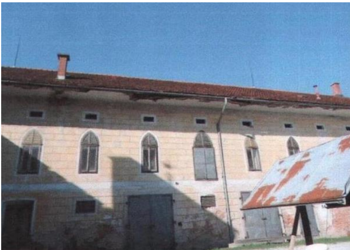
Slika 22: Poškodovan napušč zaradi zamakanja strehe na zahodnem gospodarskem poslopju. Foto: Tomaž Klančnik. Vir: Klančnik, Tomaž. September, 2012.
