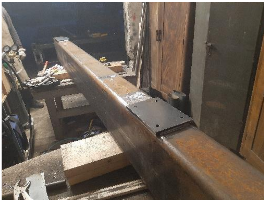
Slika 26: Varjenje plošč za pritrditev stebrov
