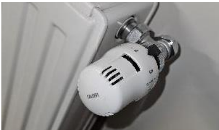
Slika 13: Termostatski ventil (Vir: Osebni arhiv)
