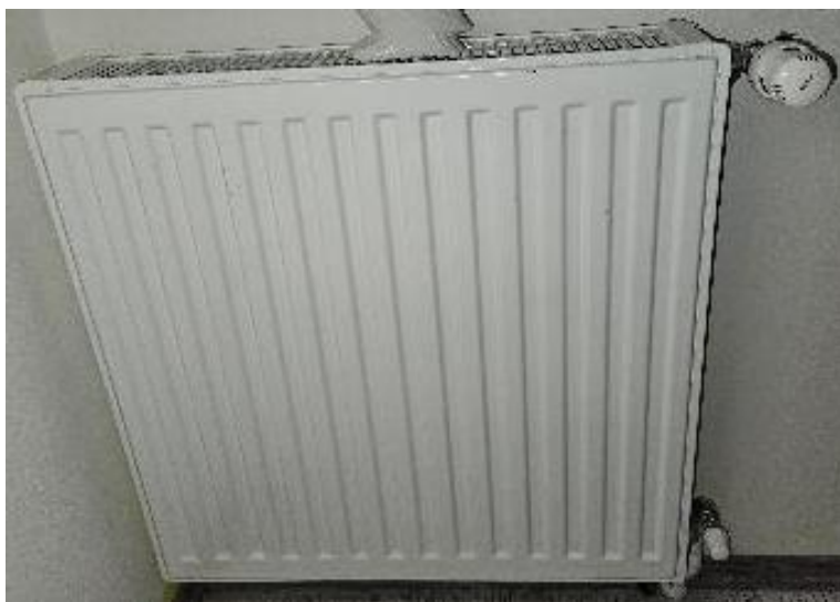
Slika 12: Radiator v spalnici
