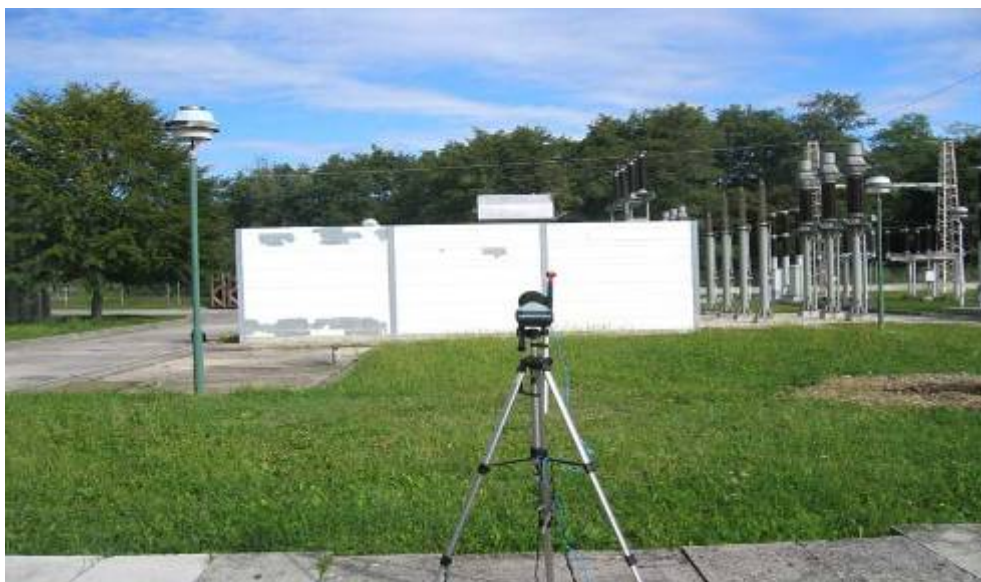
7 Slika 15: Merilna naprava hrupa na območju elektrarne.
