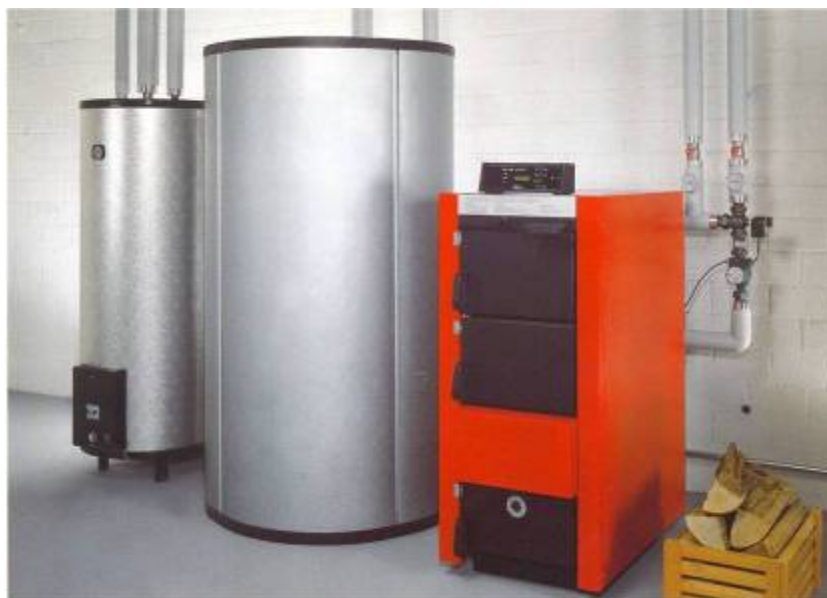
Slika 9: Kotlovnica s kotlom in htranilnikom toplote.Kotel.
