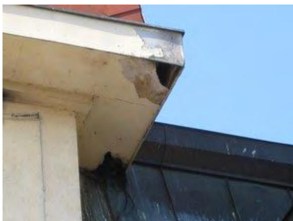
Slika 5: Dve gnezdi kavk - nadstrešek stavbe
