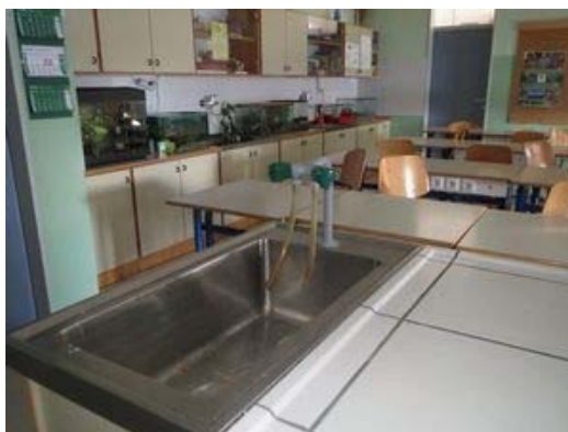
Slika 10: V naravoslovni učilnici so štirje sanitarni priključki
