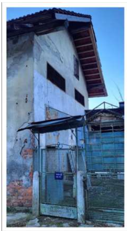
Slika 85: Čelna stran izvirne trafo postaje. Foto Bojan Rebernak, 2023.
